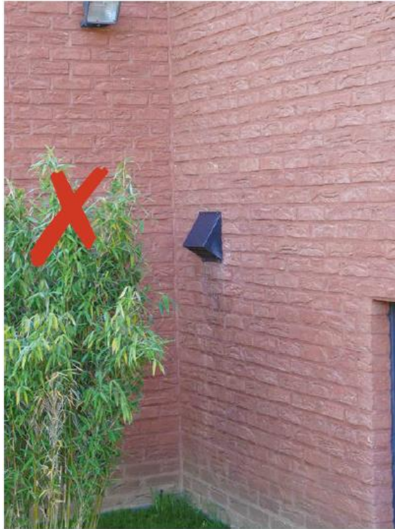
Figuur 41: Ongeschikte positie van een luchttoevoeropening, gezien het risico op overwoekering door vegetatie
