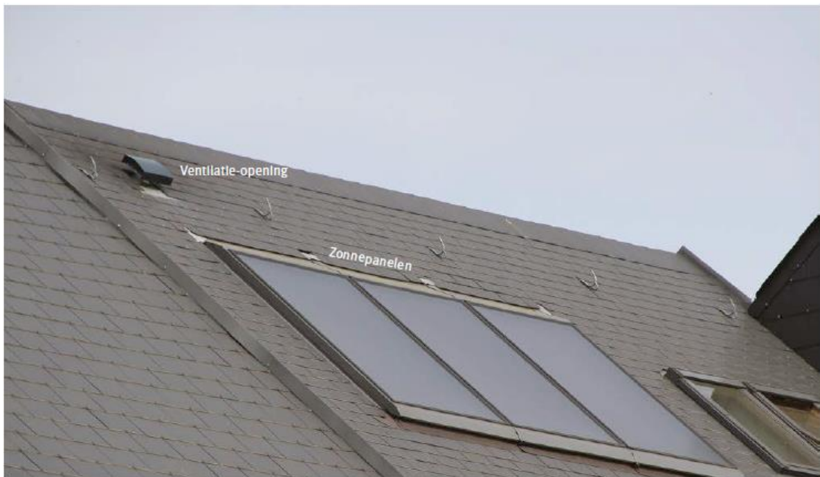
Figuur 44: De ventilatie-opening is voldoende ver verwijderd om de integratie van de zonnepanelen toe te laten en beschaduwung te vermijden
