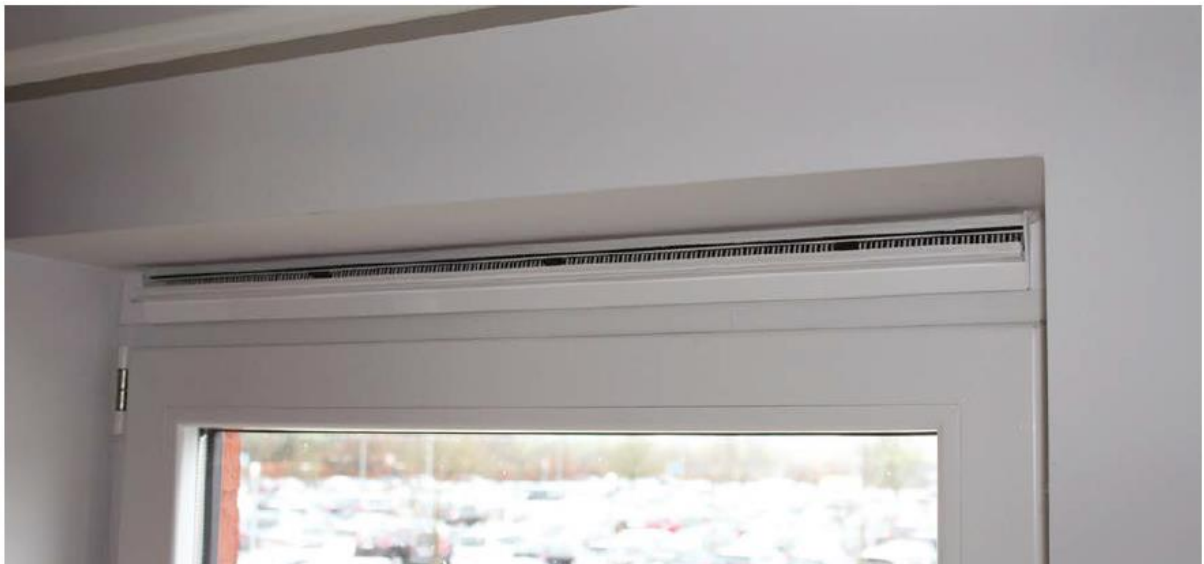
Figuur 30: Binnenzicht van een natuurlijke-toevoeropening (RTO) die geïntegreerd werd in het vensterraam
