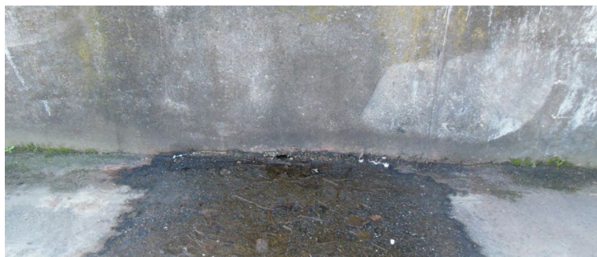
Figuur 11: Het afstromen van silosappen uit een lekkende wand van een sleufsilo (VMM, 2021).
