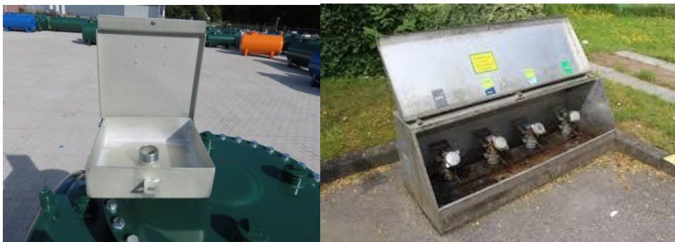
Figuur 26: lekbak rond het vulpunt op de opslagtank en lekbak waarin vulmonden worden geïnstalleerd los van de opslagplaats
