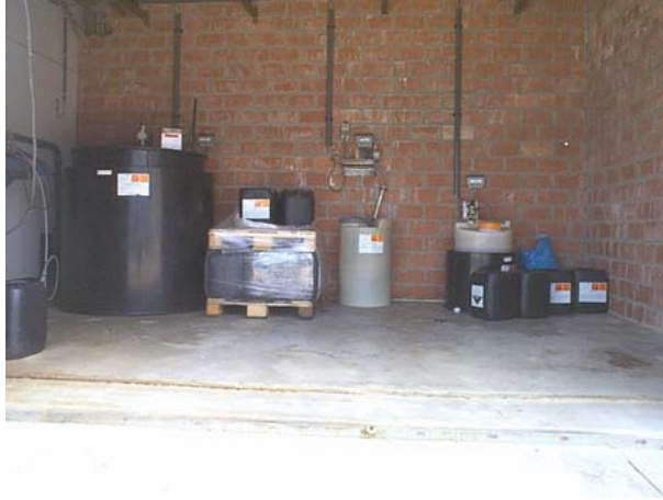
Figuur 2.11: Opslag chemicaliën
