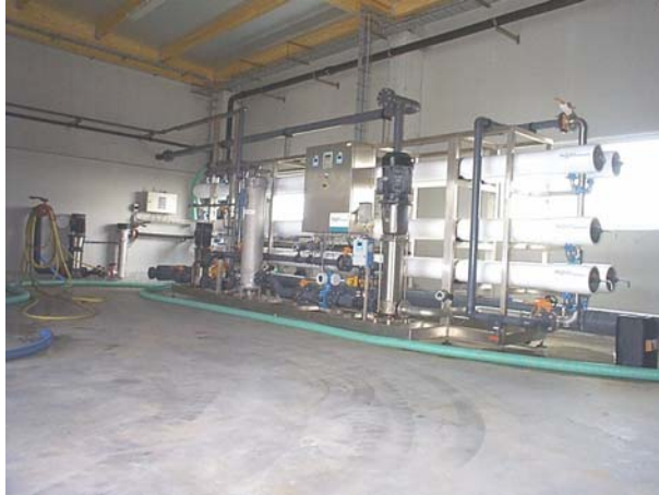
Figuur 2.8: Membranen van de omgekeerde osmose
