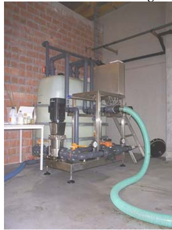
Figuur 2.9: Reinigingsinstallatie omgekeerde osmose
