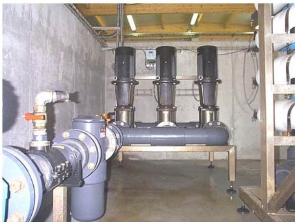
Figuur 2.7: Terugspoelpompen ultrafiltratie
