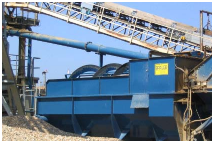
Figuur 16 : Ontwateringsinstallatie voor zeezand (Bron: Hanson)
