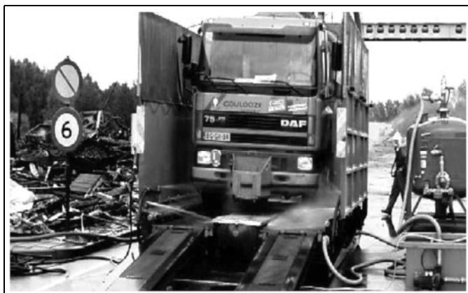
Figuur 3.15: Mobiele wasstraat voor transportmaterieel, voor het verlaten van het saneringsterrein worden de vrachtwagens schoongespoten, het verontreinigde water wordt via roosters afgevangen en verpompt naar een zuiveringsinstallatie
