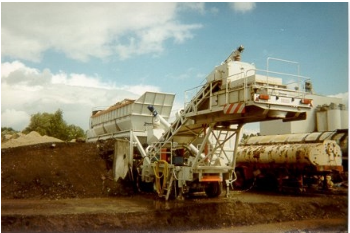
Figuur 48: Verplaatsbare Zimmer centrale (achter- en linkerzijde)
