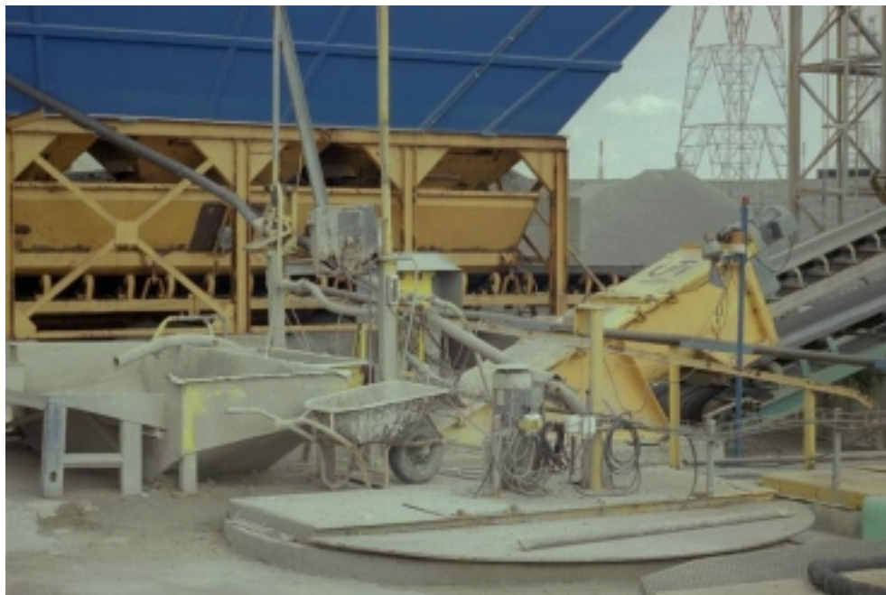
Figuur 4: Nette betonrecyclinginstallatie
