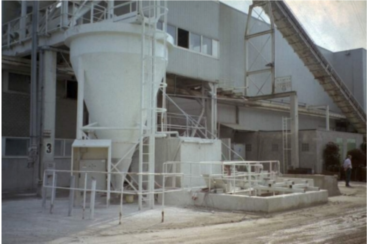
Figuur 7: Klarinstallatie voor slib/water -hergebruik
