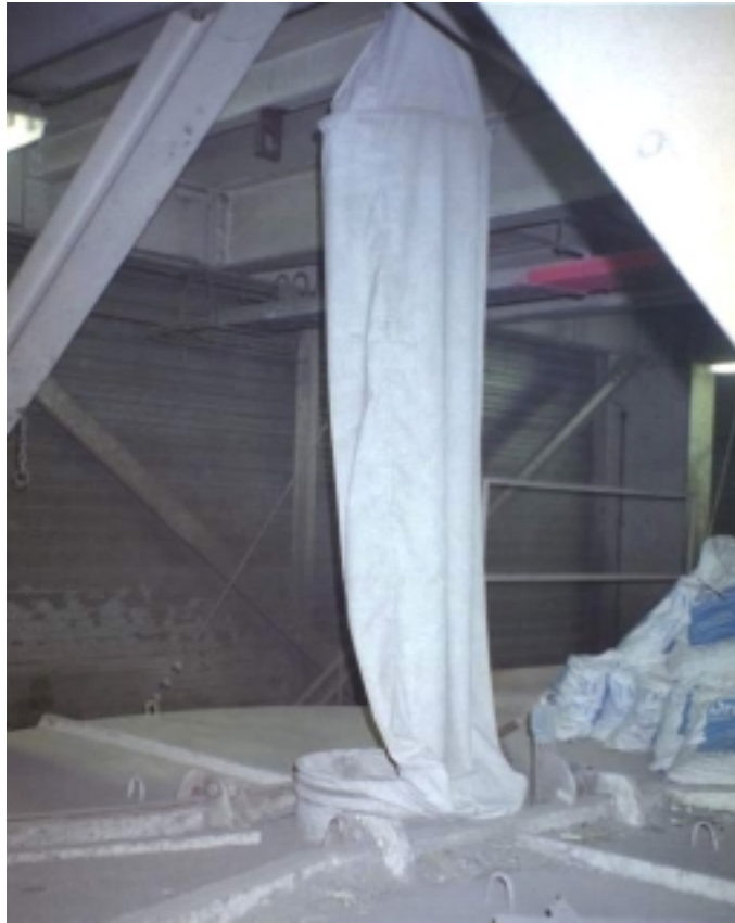
Figuur 30: Stofzak op menginstallatie
