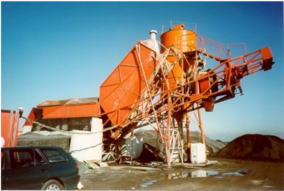
Figuur 40: Verplaatsbare SGME centrale (rechterzijde)
