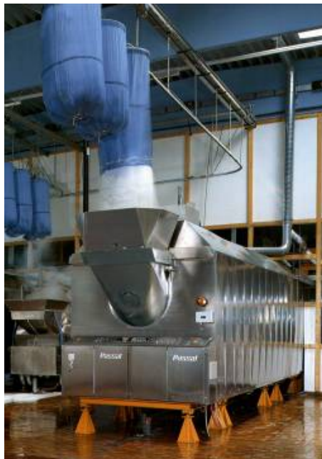
Figuur 4-1: Automatisch belading van een wastunnel
