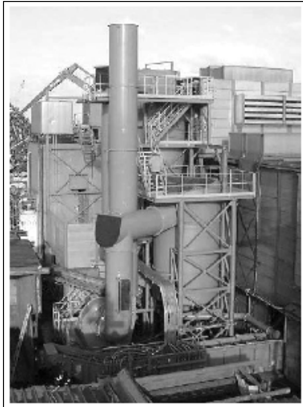
Figuur 56: Foto van een ontstoffingsinstallatie ter hoogte van het shredderhuis (rotorhuis)
