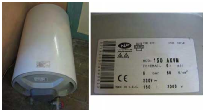
Figuur 210: Elektrisch voorraadvat met kenplaat met onder meer vermelding volume
