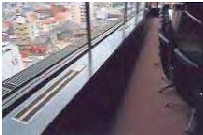
Figuur 205: Ventilconvector ingewerkt onder de ramen
