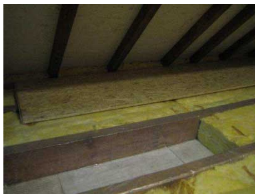
Figuur 39: Zichtbaar gelaten plafondisolatie in houten roostering
