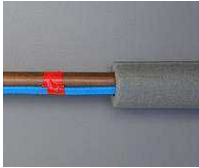
Figuur 17: Elektrisch verwarmingslint langs de warm waterleiding
