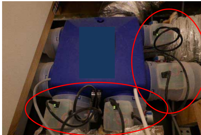
Figuur 16: Ventilatieunit voor mechanische afvoer met een afzonderlijke regelklep per ruimte/ventilatiezone
