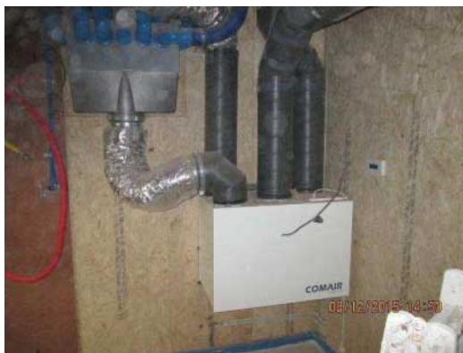
Figuur 11: Ventilatieunit voor mechanische toe-en afvoer met WTW
