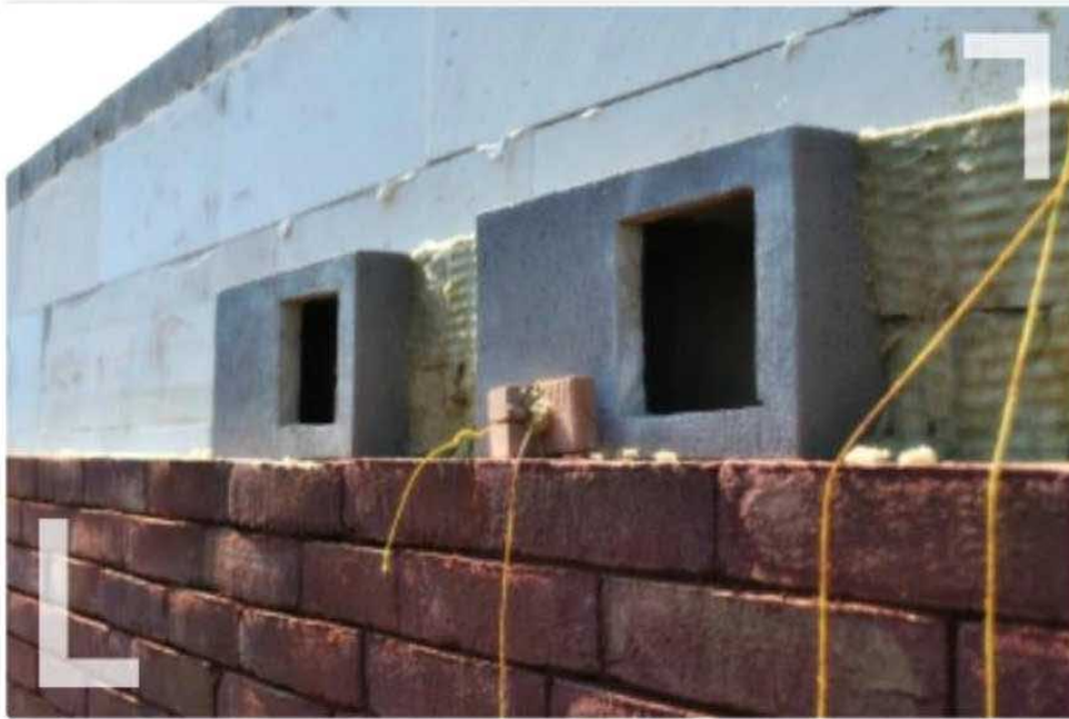
Figuur 13. Inbouwstenen met nestholtes voor Gierzwaluw bij renovatie van de Sint-Jozefkliniek in Bornem (bron: website Regionaal Landschap Schelde-Durme, www.rlsd.be )
