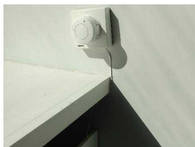
Figuur 60: Voorbeeld van een verplaatste thermostaatkraan
