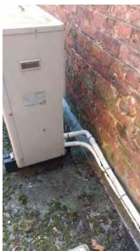
Figuur 58: Voorbeeld van een geïsoleerde koelmiddelleiding verbonden aan een buitenunit
