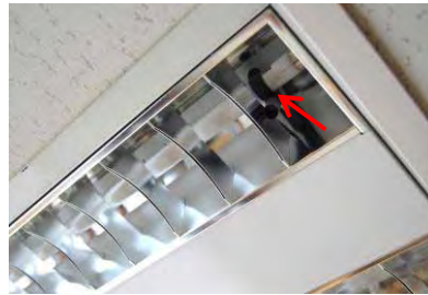
Figuur 92: Daglichtsensor op TL-verlichting in een armatuur
