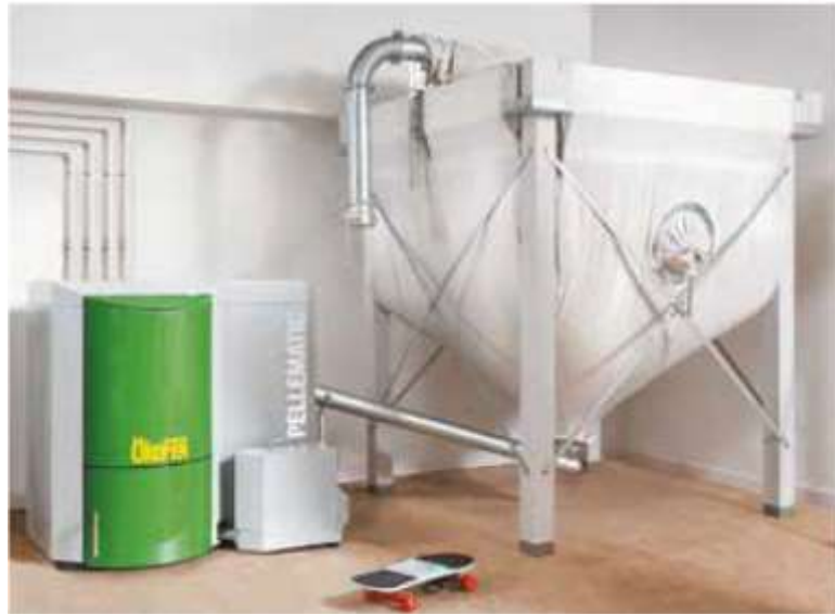
Figuur 17: Pelletketel met opslag in silo
