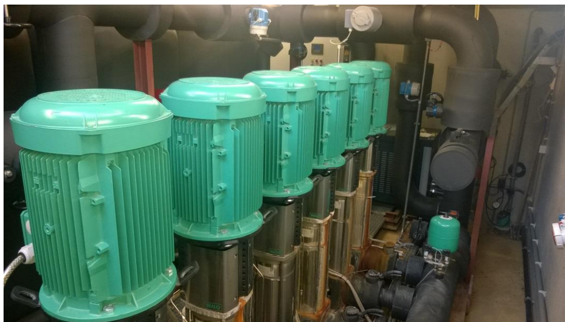
Figuur 34 - Opstelling van pompen in een ondergronds pompstation van Mijwater
