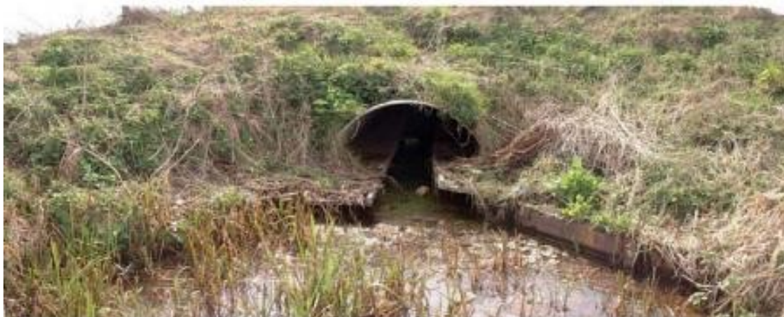
Afbeelding: Voorbeeld loopplank in duiker
