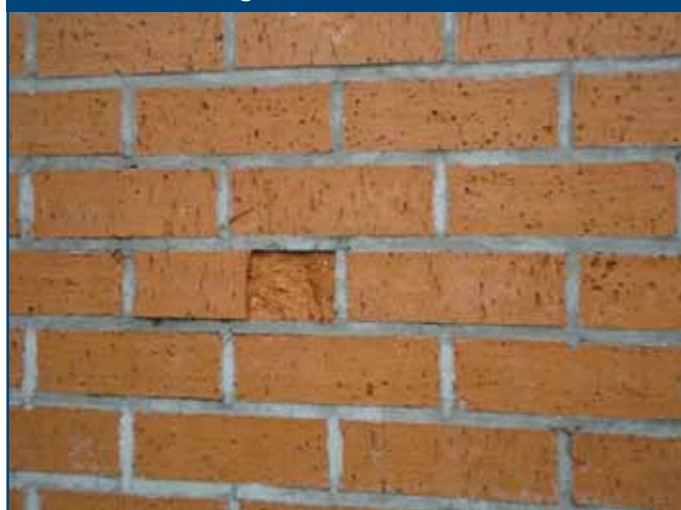
vorstschade aan gevelsteen
