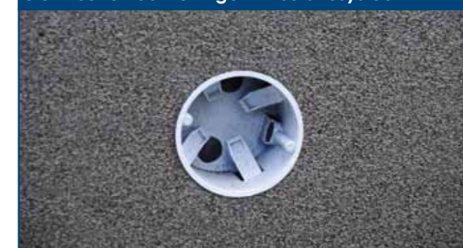
elektrische voorzieningen in isolatiesysteem
