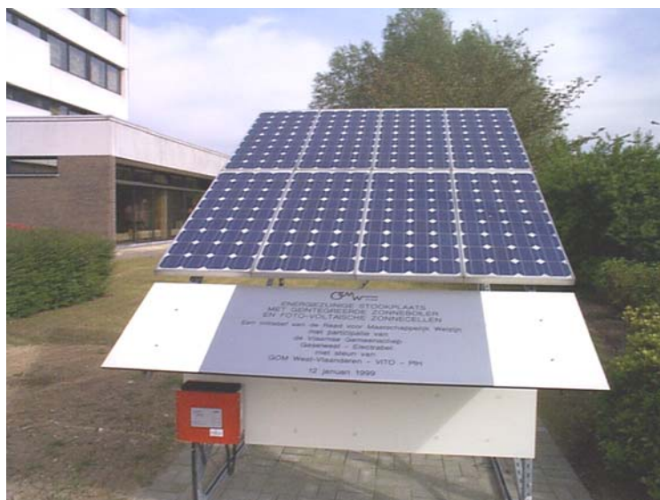
Figuur 2: Foto's van de installatie in het rustoord
