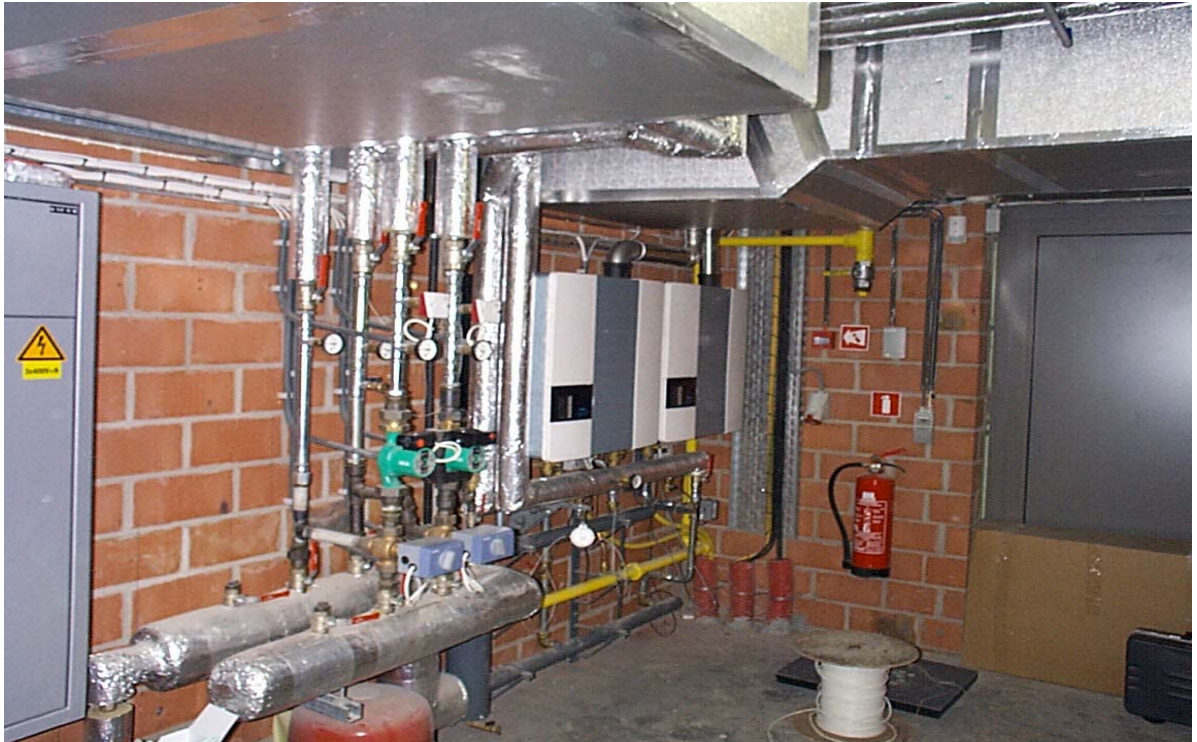
Zicht op de verwarmingsketels en verwarmingskringen
