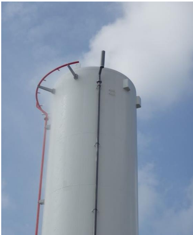
Figuur 34: Dry-delugesysteem (rode leiding) in werking ikv testprocedure op LNG-tankstation van Mattheeuws (zwarte leiding is de centrale afblaasvoorziening of vent stack).
