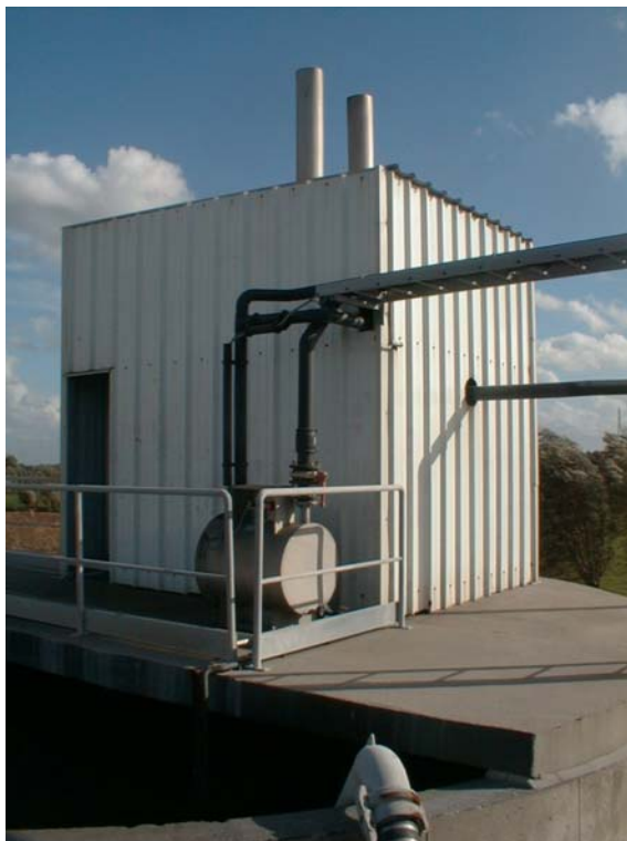
Figuur 2.3: Foto van dompelbrander met surpressor
