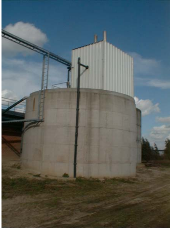
Figuur 2.2: Foto van mengtank en dompelbrander
