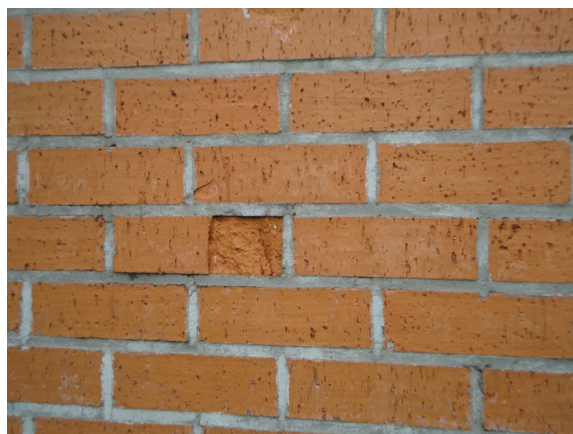
Figuur 21: Vorstschade aan bakstenen
