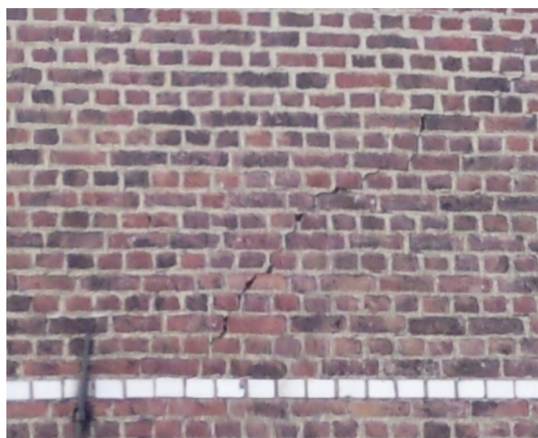
Figuur 17: Scheurvorming in metselwerk
